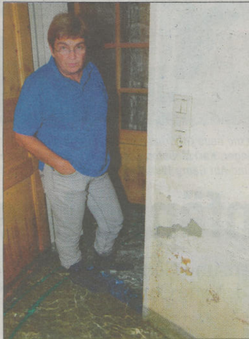
Durch permanentes Pumpen kann der Grundwasserstand im Hauskeller der Familie Oberhofer auf ca. 20 cm gehalten werden. Dr. Christa Oberhofer kann ihre mittlerweile völlig unbrauchbar gewordenen Kellerräume nur mit Gummistiefeln betreten. FOTOS: RAPP
